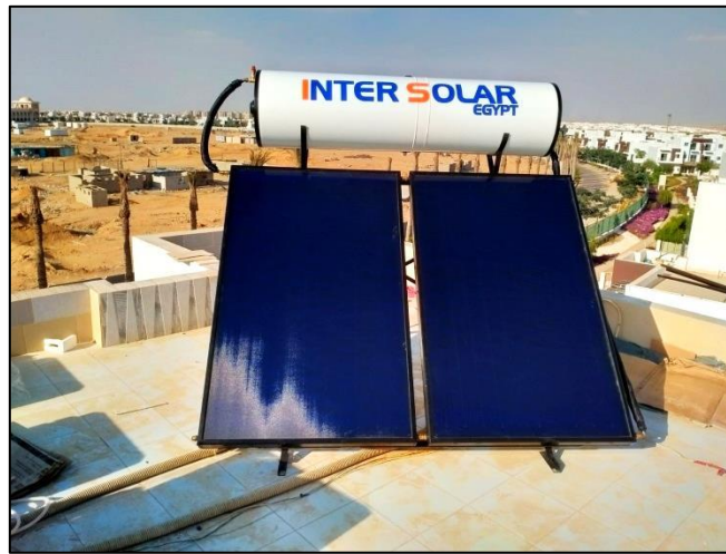
Şekil 2.5. Güneş enerjisi kollektörleri çatı uygulaması örneği
