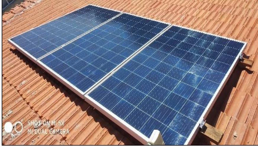
Şekil 4.5. 275Wp polikristal güneş panellerinin çatı montaj sistemi
