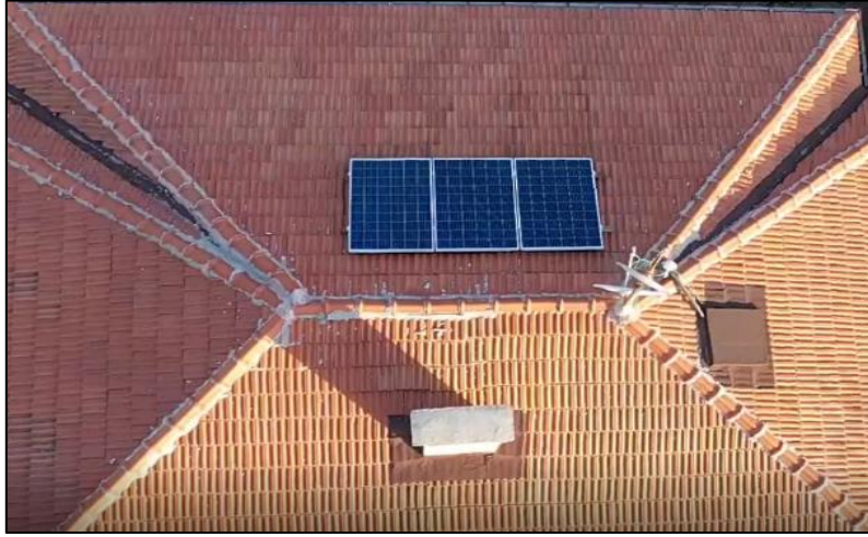
Şekil 4.4. 275Wp polikristal güneş panellerinin çatı konumu
