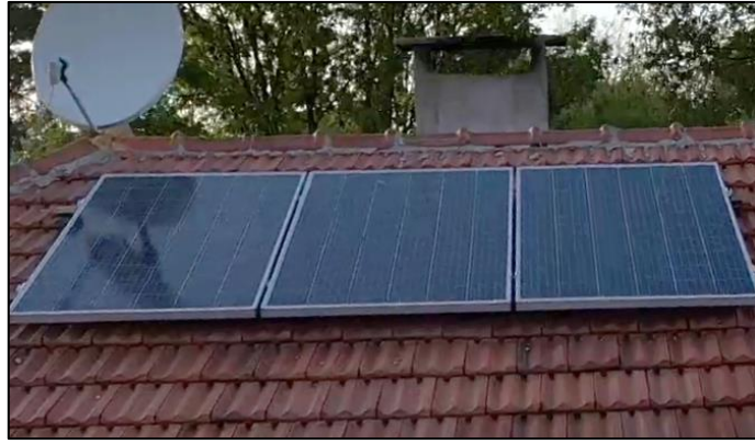
Şekil 3.2. Güneş panelinin gölgelenmesi
