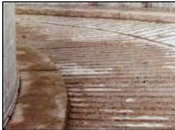
Şekil 2.5.Beton kaplamada oluşan soyulma problemi (Baradan,2010).
