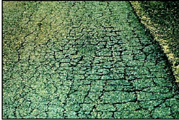
Şekil 2.9. Timsah sırtı çatlak oluşumu (Karaşahin, 2014).
