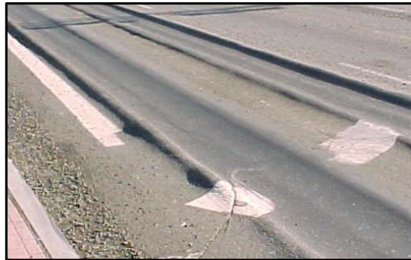
Őekil 2.8. Esnek üstyapıda tekerlek izi oluşumu (Karařahin, 2014).
