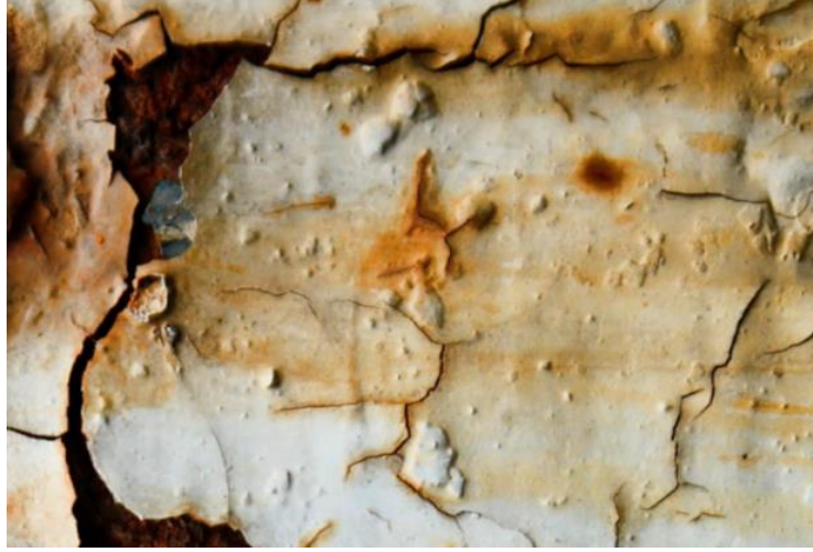
Şekil 3.1. Korozyona uğramış bir metal.
