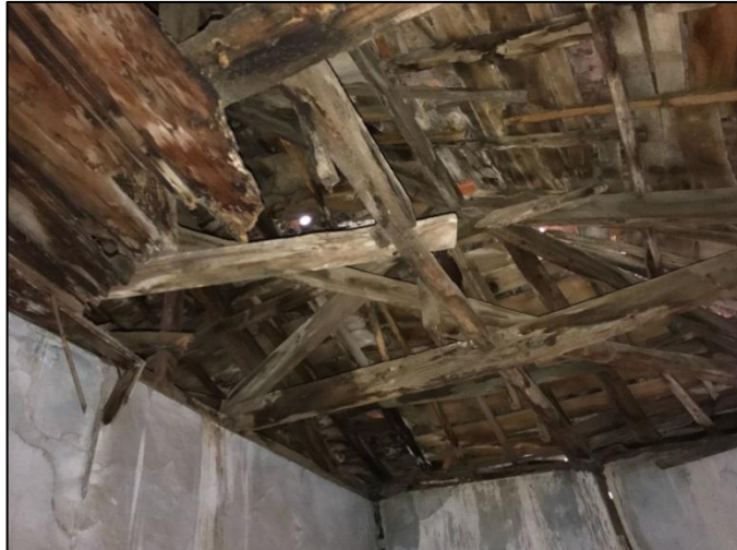
Şekil 5.2. Deforme olmuş çatı taşıyıcıları.
