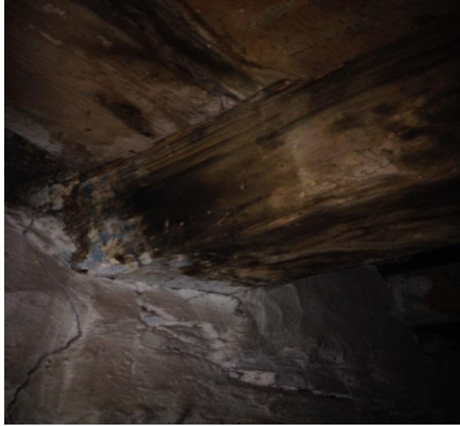
Şekil 5.4. Döşeme kirişi bağlantı noktası deformasyonu.
