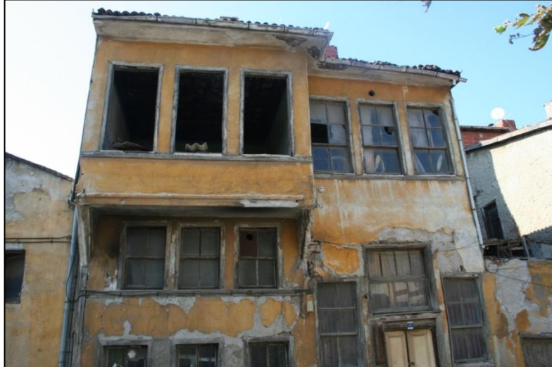
Şekil 5.10. Yapı dış görünüş risk durumu.
