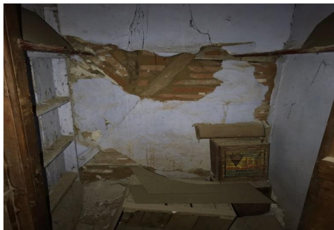
Şekil 5.9. Dış duvar düzlem dışı deformasyonu.
