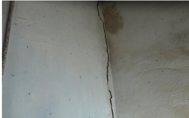
Şekil 5.5. Düşey taşıyıcı duvar ayrışması.
