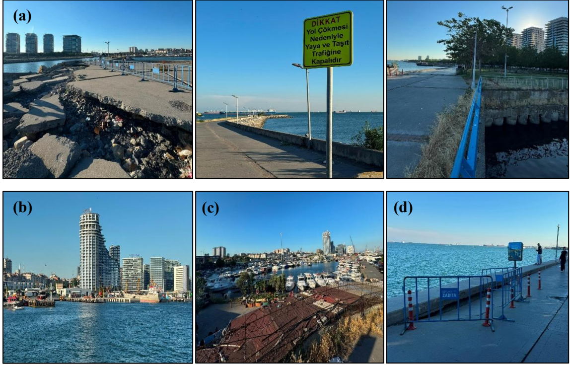
Şekil 3.10. Zeytinburnu dolgu alanında çöken zemin (a), Zeyport liman işletmeleri (b), Zeytinburnu dolgu alanında dikenli tel çitle sınırlanmış tekne bağlama alanı (c), Ataköy Zeytinburnu arası sahil dolgusunda çöken zemin (d)
