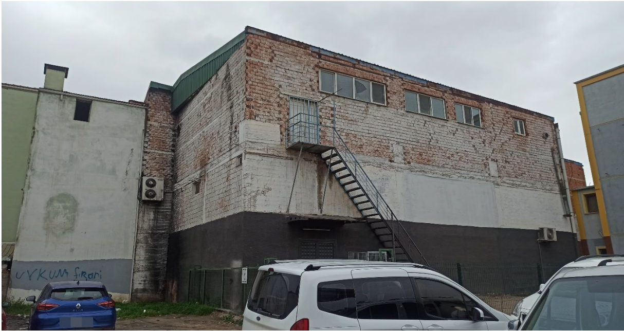
Fotoğraf 3.3 İlçe 'de Bulunan Üst Kat Düğün Salonu Alt Kat Ticaret Amaçlı Kullanılan Yönetmeliğe Uymayan Bina
