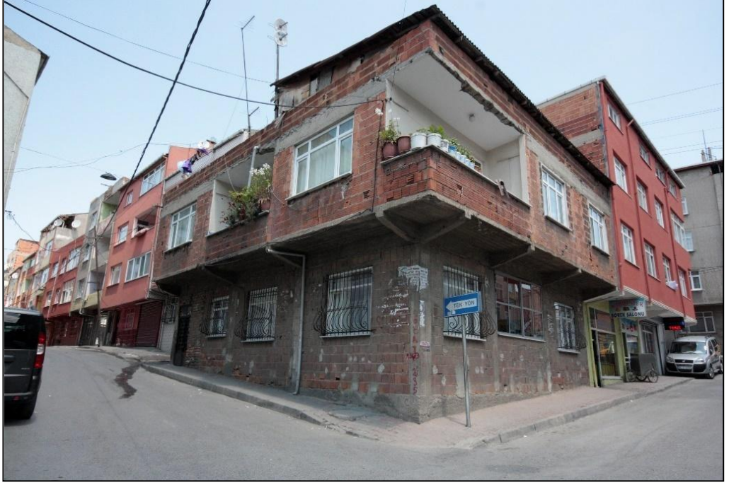
Foto 20: Havaalanı Mahallesi Sınırları İçerisinde Yer Alan Depreme Dayanıksız Olduğu Tespit Edilen Bir Binadan Görünüm, 2015
