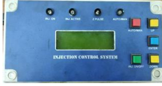
Şekil 3.7 Enjeksiyon kontrol sistemi paneli
