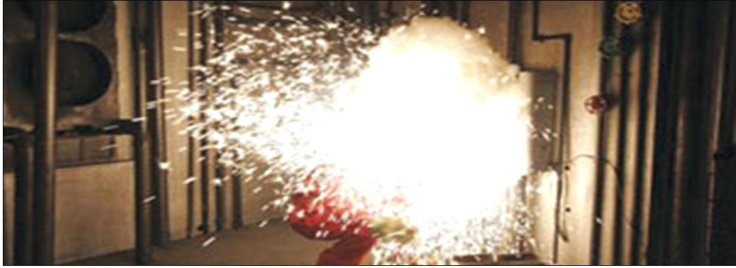
Şekil 3.7. Kısmi deşarj sonrası oluşan kısa devre problemi ve gerçekleşen patlama.
