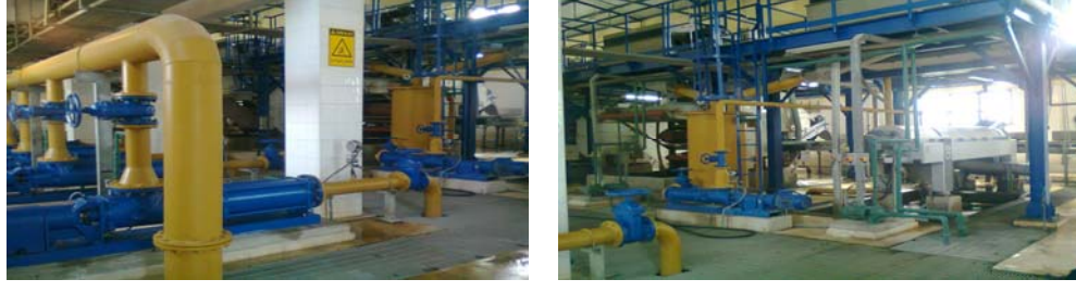
Şekil 3.42 Çamur ayırma ünitesi.
