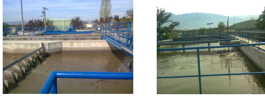
Şekil 3.36 Ön arıtma tankı.
