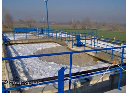
Şekil 3.50 Çalı atıksu arıtma tesisi.
