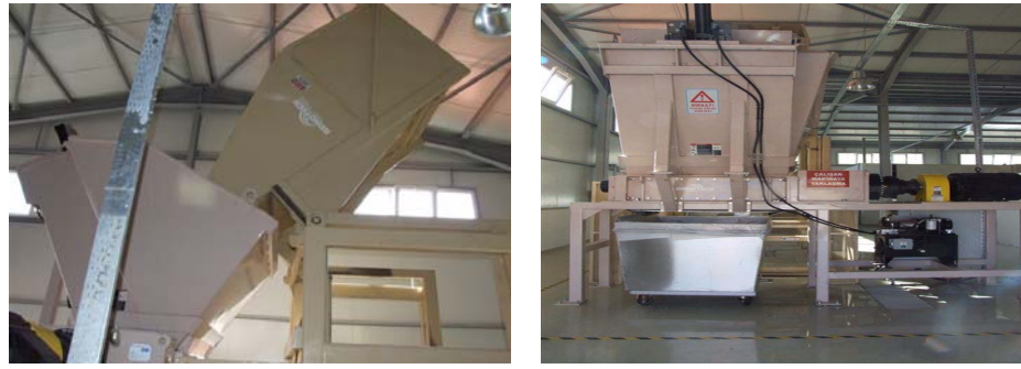
Şekil 3.56 Parçalama ünitesi boşaltma ve dolum aşaması.
