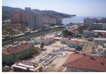
Şekil 3.48 Gemlik atık su ön arıtma tesisi
