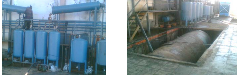
Şekil 3.21 Damıtma yağ tank sistemi (Osmangazi Belediyesi).
