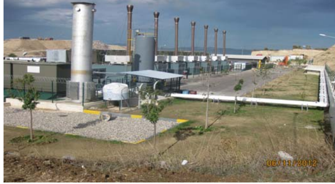
Şekil 6.4 Enerji dönüşüm ünitesi (metan gazı depo alanı-Bursa)
