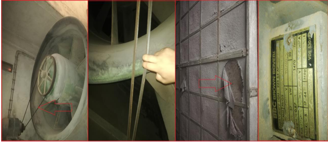
Şekil 4.6. İncelemesi yapılan klima sisteminden görseller.
