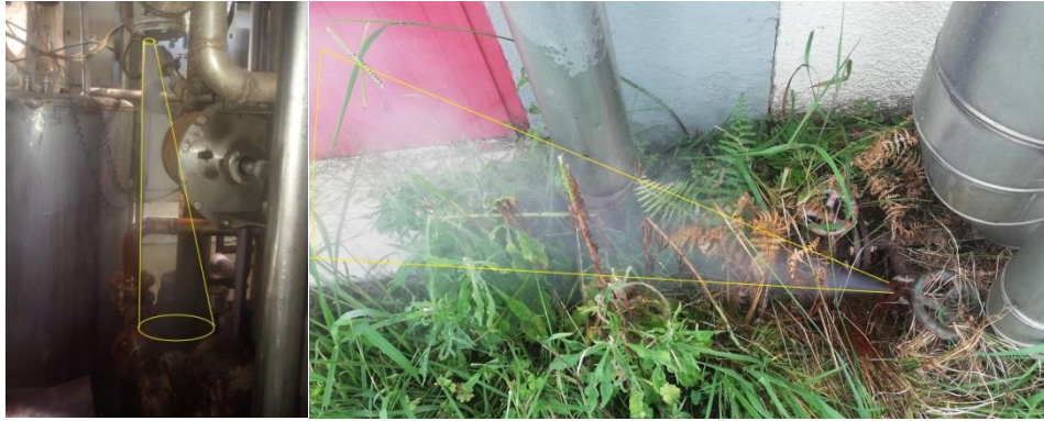
Şekil.5.3. Örnek buhar kaçakları fotoğrafı.
