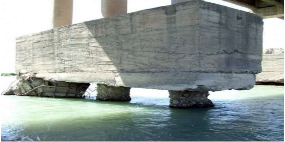
Şekil 4.4. Adıyaman Göksu köprüsü ayaklarında oluşan oyulma, (URL 7, 2020).
