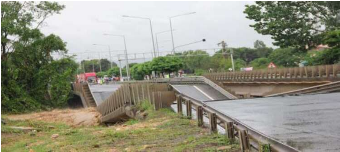
Şekil 4.7. Ordu, Ünye sahil yolu köprüsü, sel afeti, (URL 4, 2019)
