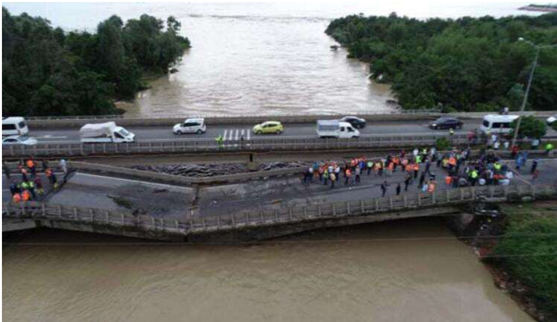
Şekil 1.1. Ordu, Ünye sahil yolu köprüsü, sel afeti, (URL 4, 2019)
