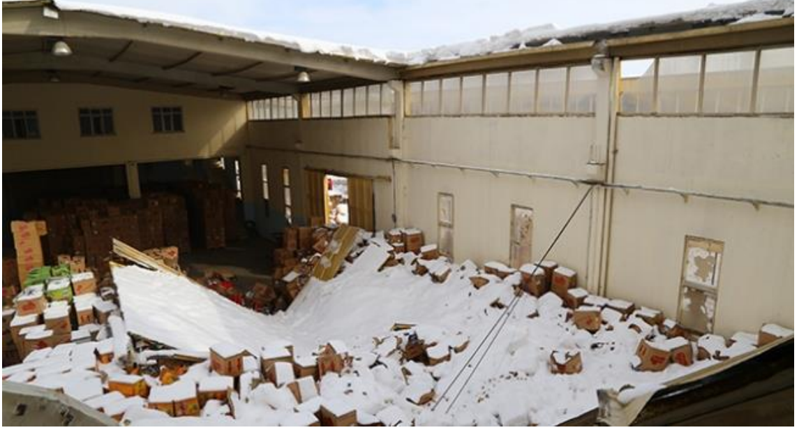
Şekil 1.2. Konya’da fabrika çatısı çökmesi(URL-2).
