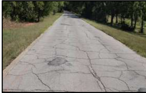
Şekil 3.2. Betondaki donma-çözülme hasarı (Yazıcı, 2014).
