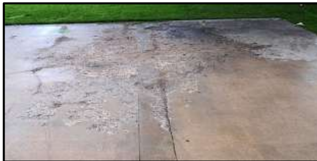
Şekil 3.1. Betondaki aşınma hasarı (Yazıcı, 2014).
