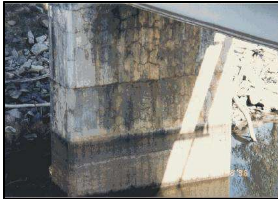
Şekil 3.8. ASR saldırısına uğramış beton (Yazıcı, 2014).
