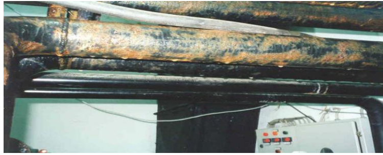
Şekil 5.11. Tesisatta yoğuşma (Diz, 2009).
