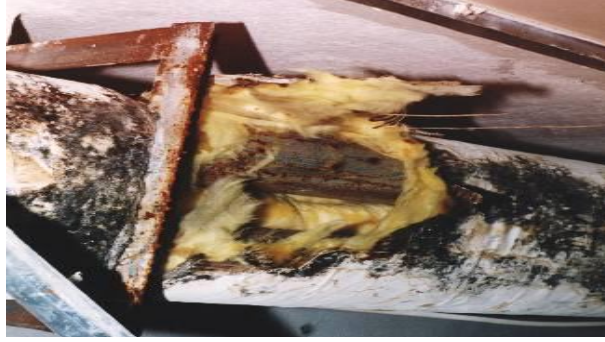
Şekil 5.15. Yoğuşma sebebiyle zarar görmüş bir tesisat (Böke, 2017).
