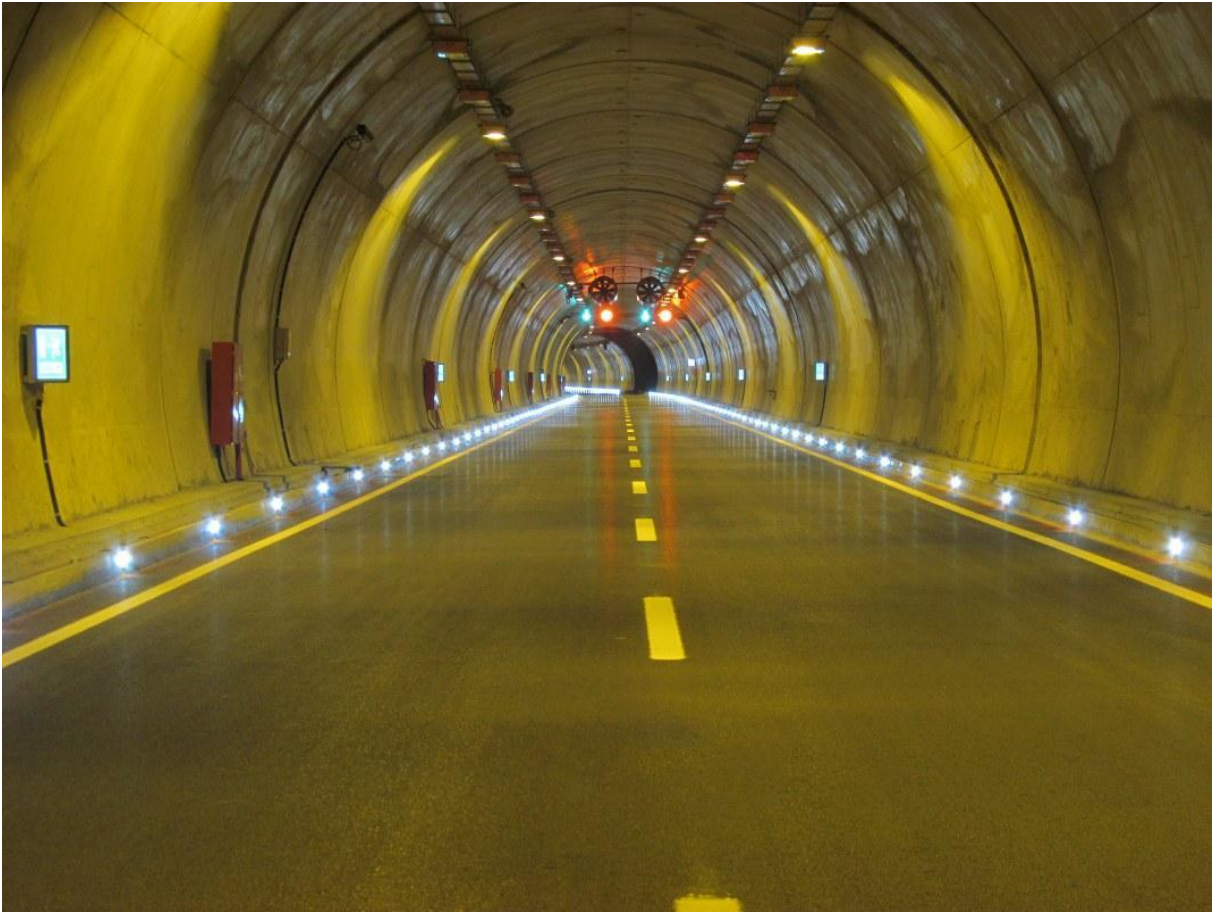
Şekil 3.5. Tünel Aydınlatması Görseli
