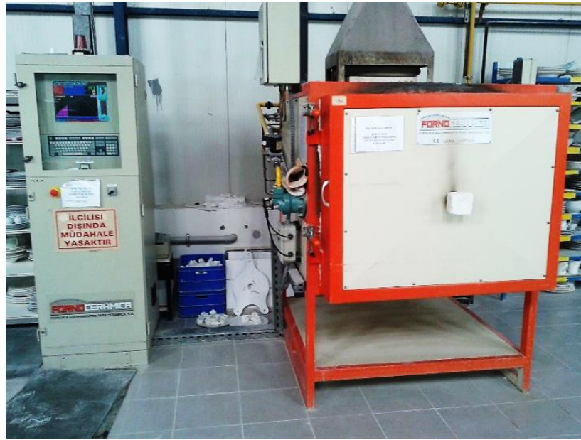
Şekil 6.5. Sinterleme işleminde kullanılan kamara tünel fırın
