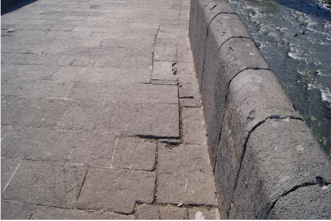
Şekil 2.18. Murat Köprüsü Döşemesinde (K5 Kemerinin Üstü) Oluşan Oturmalar ve Korkuluktaki Derz Kayıpları.
