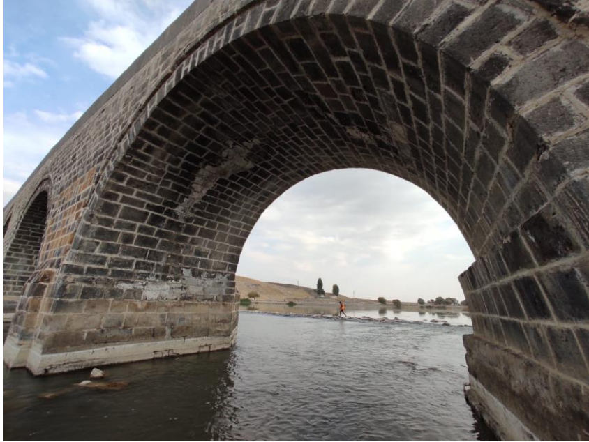
Şekil 2.15. Murat Köprüsü K2 Kemerinin İç Yüzeyinde ve Ayak Diplerinde Oluşan Kireçlenmeler
