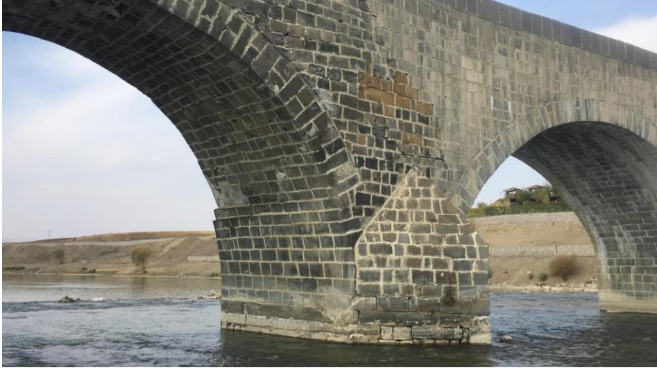
Şekil 2.16. Murat Köprüsü A7 Ayağı Oluşan Derz Boşalmaları ve Nehir Suyu Kaynaklı Kireçlenme ve Kararmalar.
