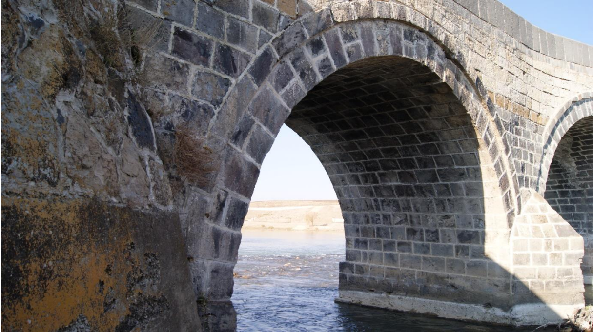
Şekil 2.19. Murat Köprüsü A1 Ayağında Oluşan Bitkilenmeler ve A2 Ayağında Oluşan Malzeme Kayıpları
