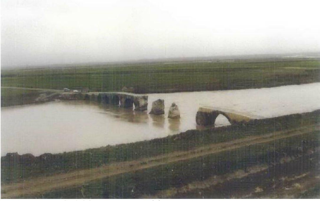
Şekil 2.3. Murat köprüsü Yıkılan Kemerler Memba Görünüşü Kaynak: (Öztürk, 2005: 7)
