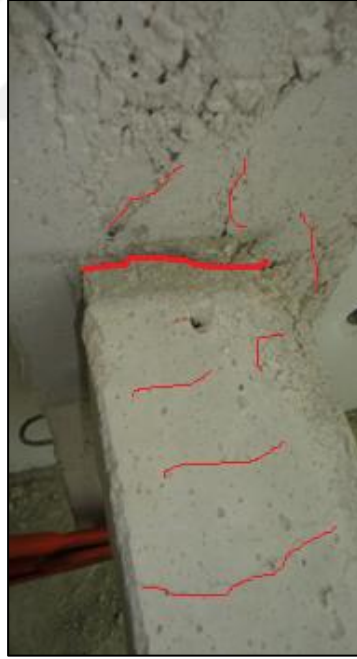
Şekil 4.45. S5 deney elemanında meydana gelen çatlak gelişimi
