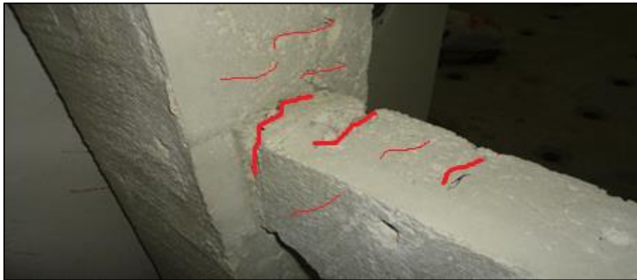
Şekil 4.72. S8 deney elemanında meydana gelen çatlak gelişimi
