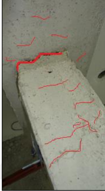
Şekil 4.54. S6 deney elemanında meydana gelen çatlak gelişimi.
