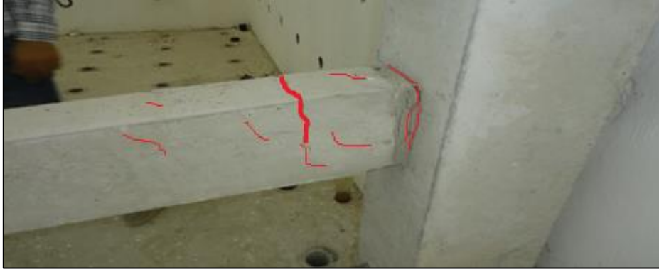
Şekil 4.117. S13 deney elemanında meydana gelen çatlak gelişimi
