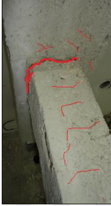
Şekil 4.63. S7 deney elemanında meydana gelen çatlak gelişimi.
