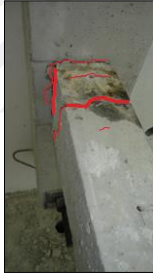
Şekil 4.108. S12 deney elemanında meydana gelen çatlak gelişimi
