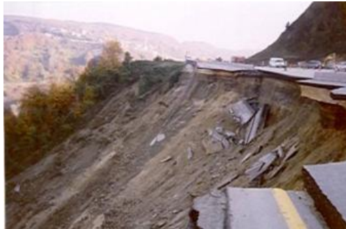
Şekil 4.4. Düzce depreminden sonra yol güzergahında meydana gelen heyelan
