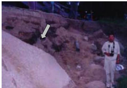
Şekil 4.11. Normal fay ile kesişen borunun zeminde oluşan düşey deformasyonlar sonucunda kırılması
