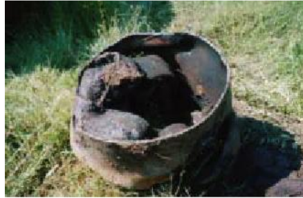
Şekil 4.10. Çelik su borusunun deprem sonucunda burkulmuş hali
