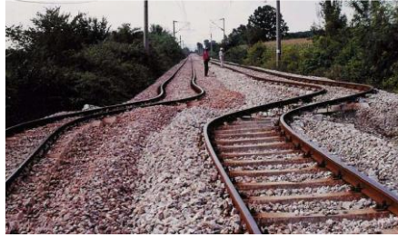
Şekil 4.6. 1999 Marmara depremi sonrasında demiryolu hattında oluşan KYD
