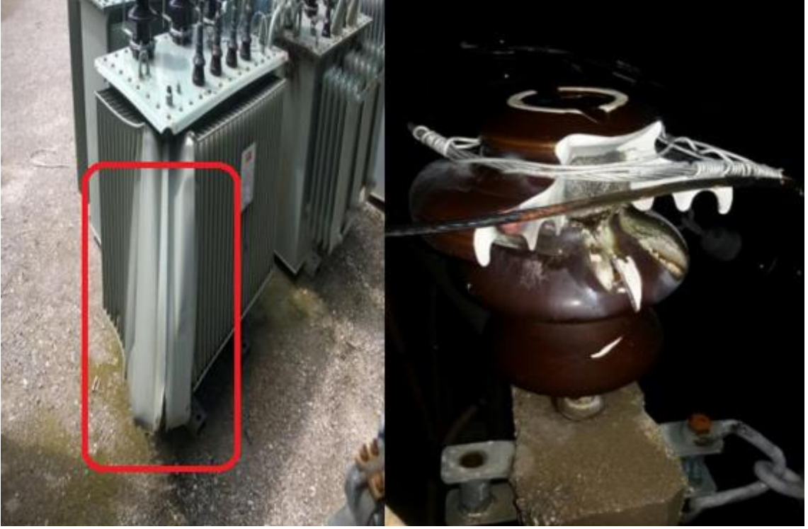
Şekil 4.26. Şarjlı havalarda yıldırım kaynaklı oluşan arızalar
