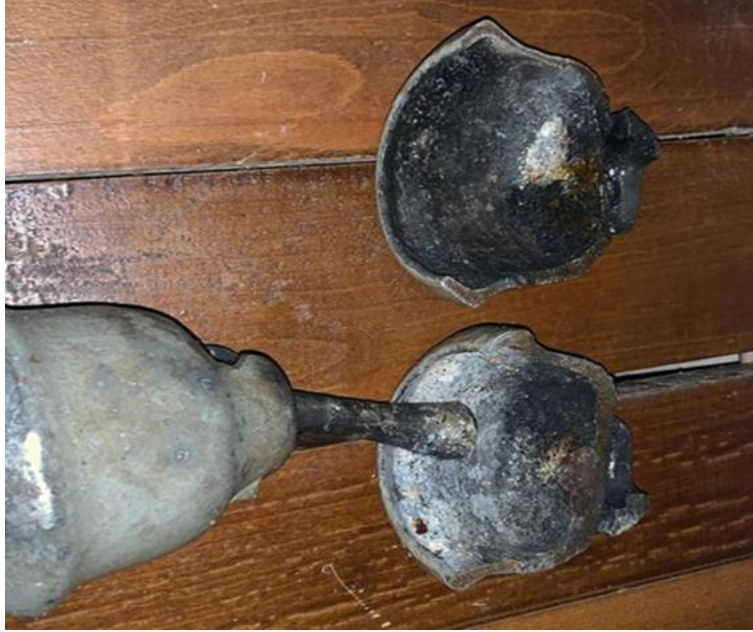
Şekil 4.20. Gergi izolatörünün patlaması
