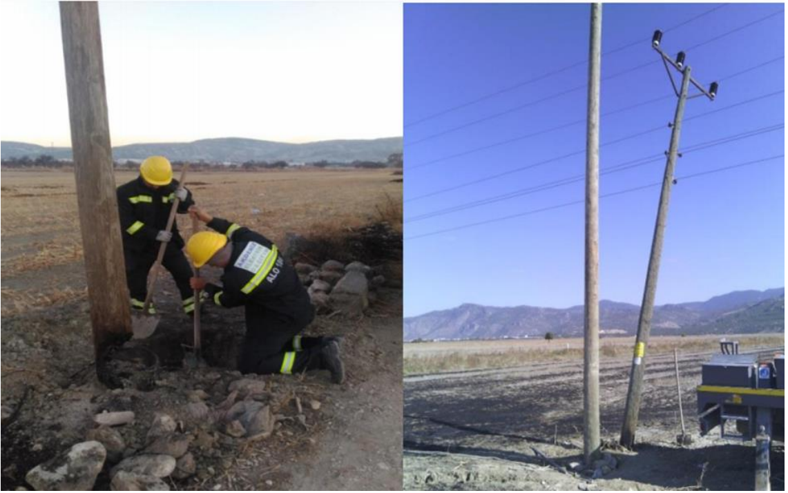
Şekil 4.29. Anızların yakılması ile ağaç direklerin zarar görmesi sonucu oluşan arızalar Kaynak: (Çifçi vd, 2017: 10)
