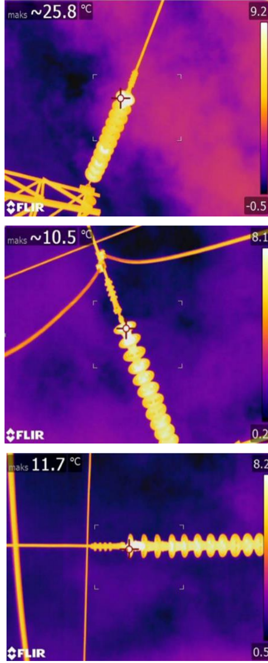
Şekil 4.17. Termal kamera ölçümlerinde A, B, C fazlarına ait izolatör görüntüleri
