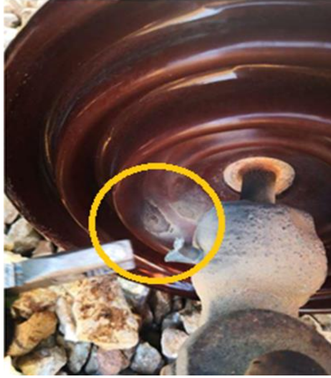
Şekil 4.18. A fazına ait arızalı izolatör
