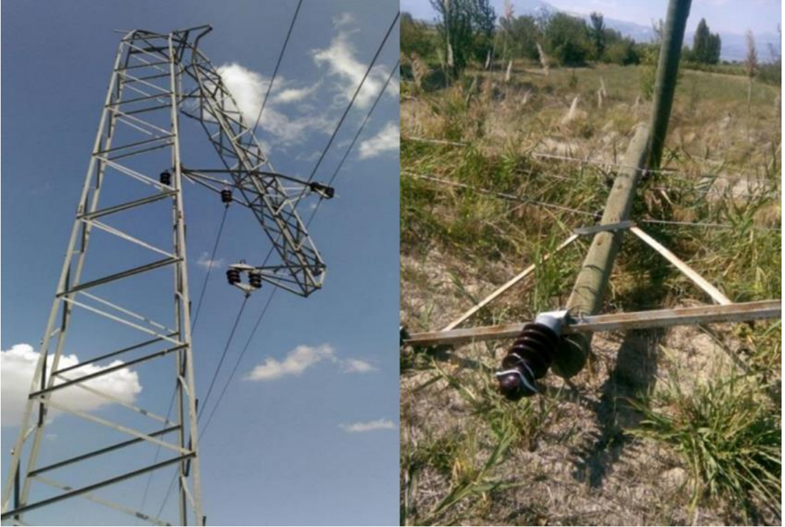
Şekil 4.25. Rüzgâr nedeniyle oluşan arızalar
