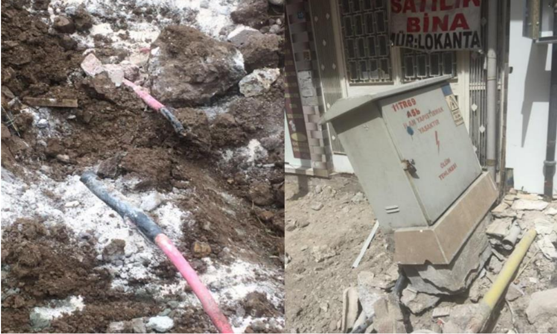
Şekil 4.31. Kazı çalışmalarından kaynaklı arızalar
