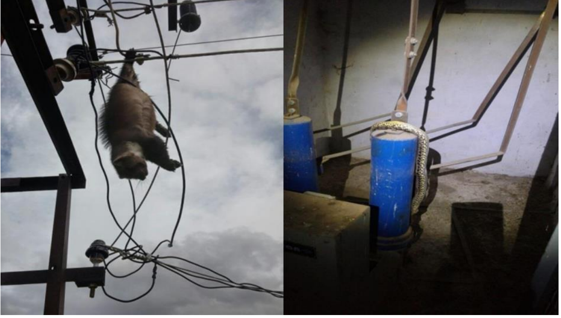
Şekil 4.28. Hayvan kaynaklı oluşan arızalar Kaynak: (Çifçi vd, 2017: 10)
