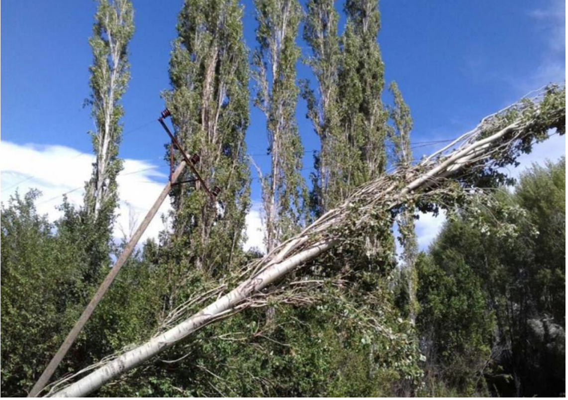
Şekil 4.30. Ağaç devrilmesi sonucu oluşan arızalar
