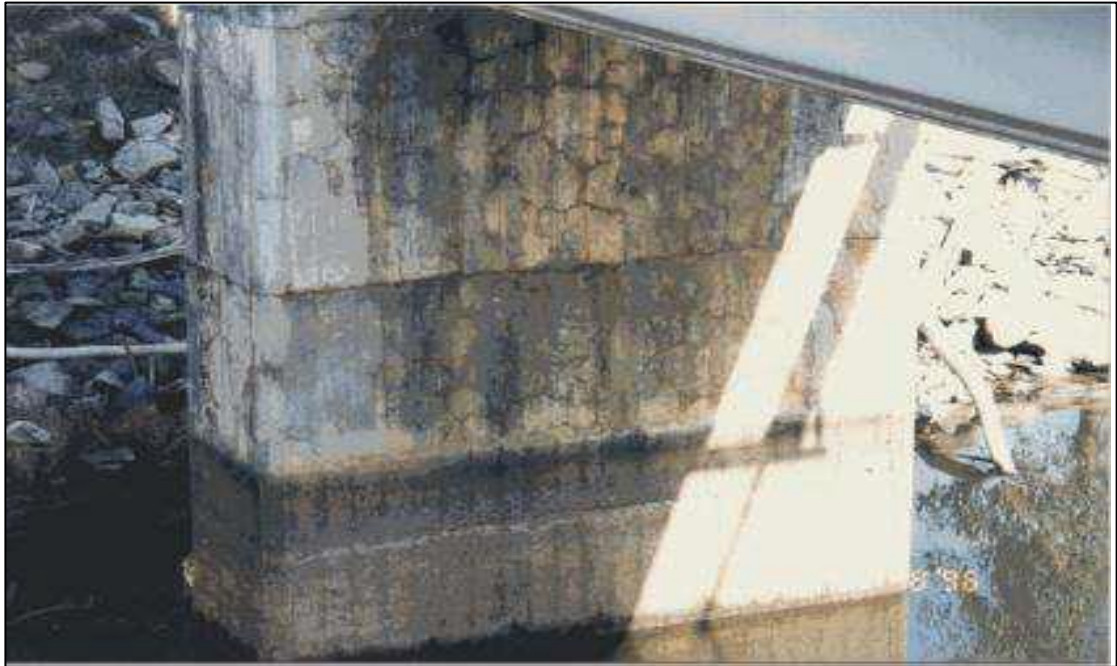
Şekil 3.4. ASR'ye maruz kalmış beton örneęi (URL-3, 2014)
