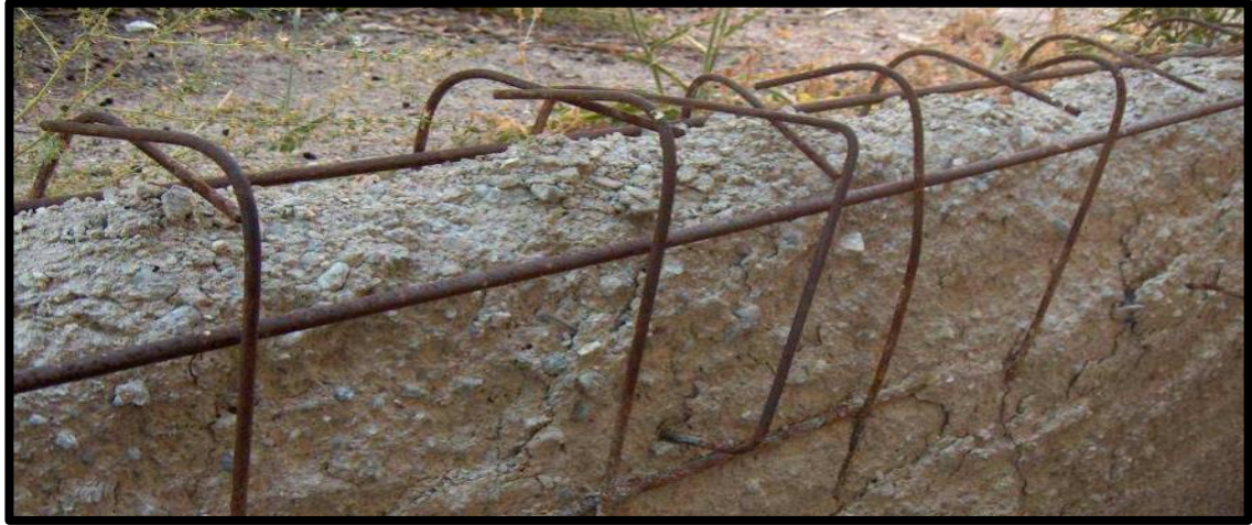
Şekil 3.1. Betonun donma çözülme etkisine maruz kalmış bir örneği (Tosun, 2015)
