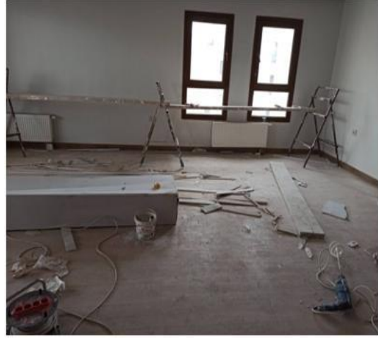
Şekil 4.8. Üst katta yer alan konutun su sızdıran tavanının tadilatı
