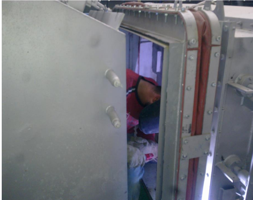
Şekil 7.8. Fırın 7 atık ısı ekonomizeri montajı.
