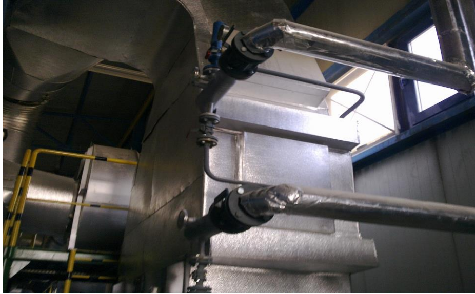
Şekil 7.5. Ekonomizer montajından sonraki görünüm.
