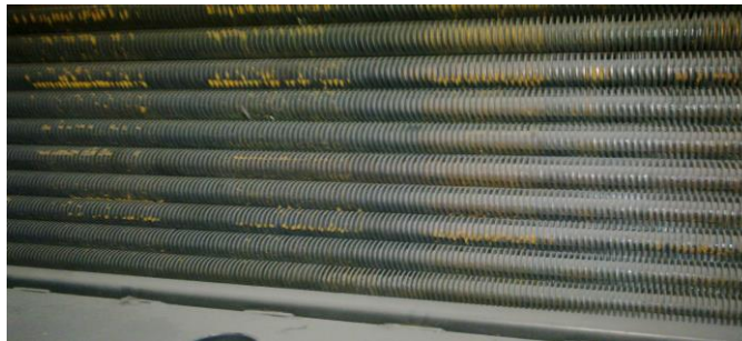
Şekil 7.4. Ekonomizer kanal içindeki ısı değiştirici borular.
