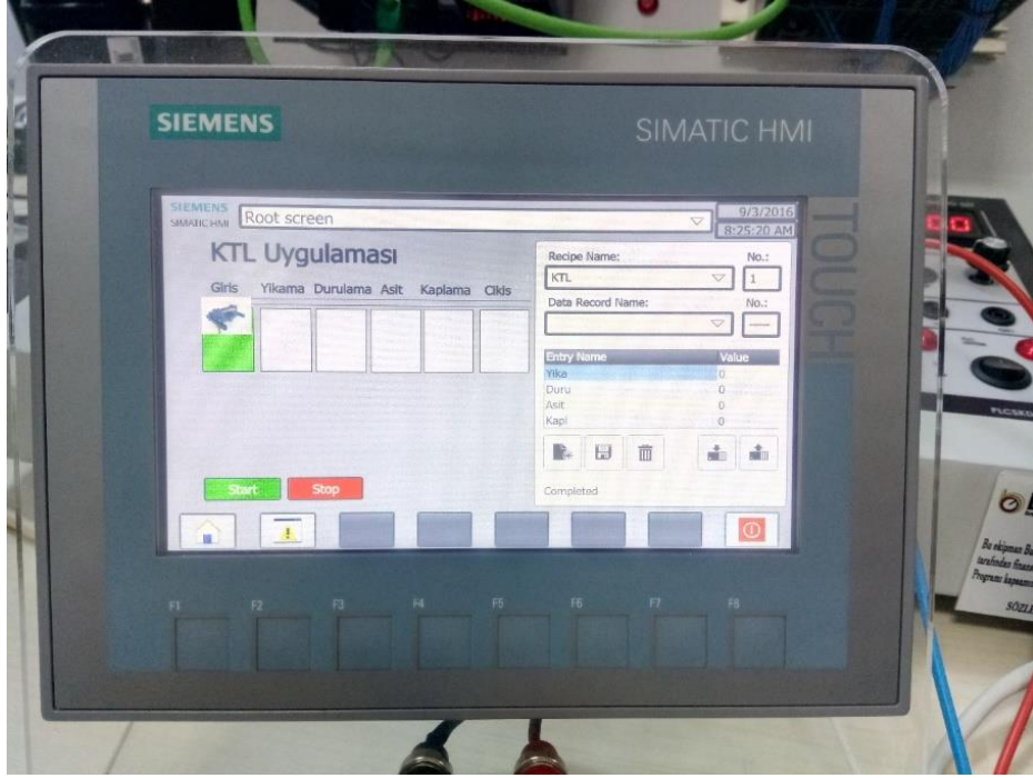
Şekil 11: Siemens marka bir SCADA operatör paneli
