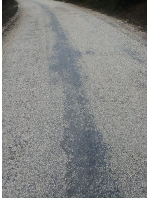
Şekil 2.7. Sathi kaplama agrega sökülmesi
