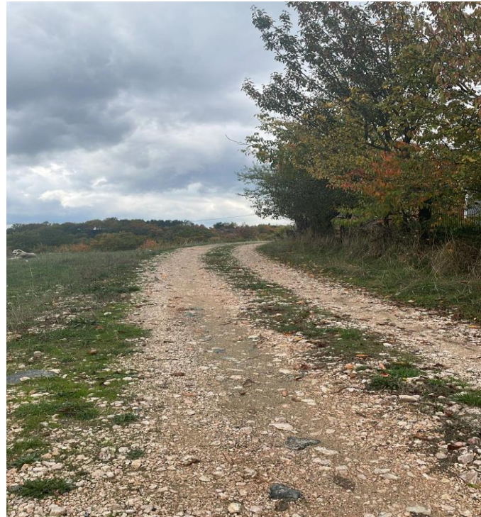
Fotoğraf 3.33. Dağdibi Köyü tarla yolu. Tekerlek izlerinden dolayı hasar alan toprak (2024).
