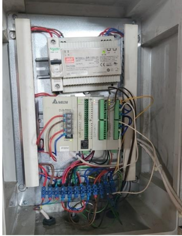
Şekil 3.10 Deney düzeneği PLC pano iç yapısı.
