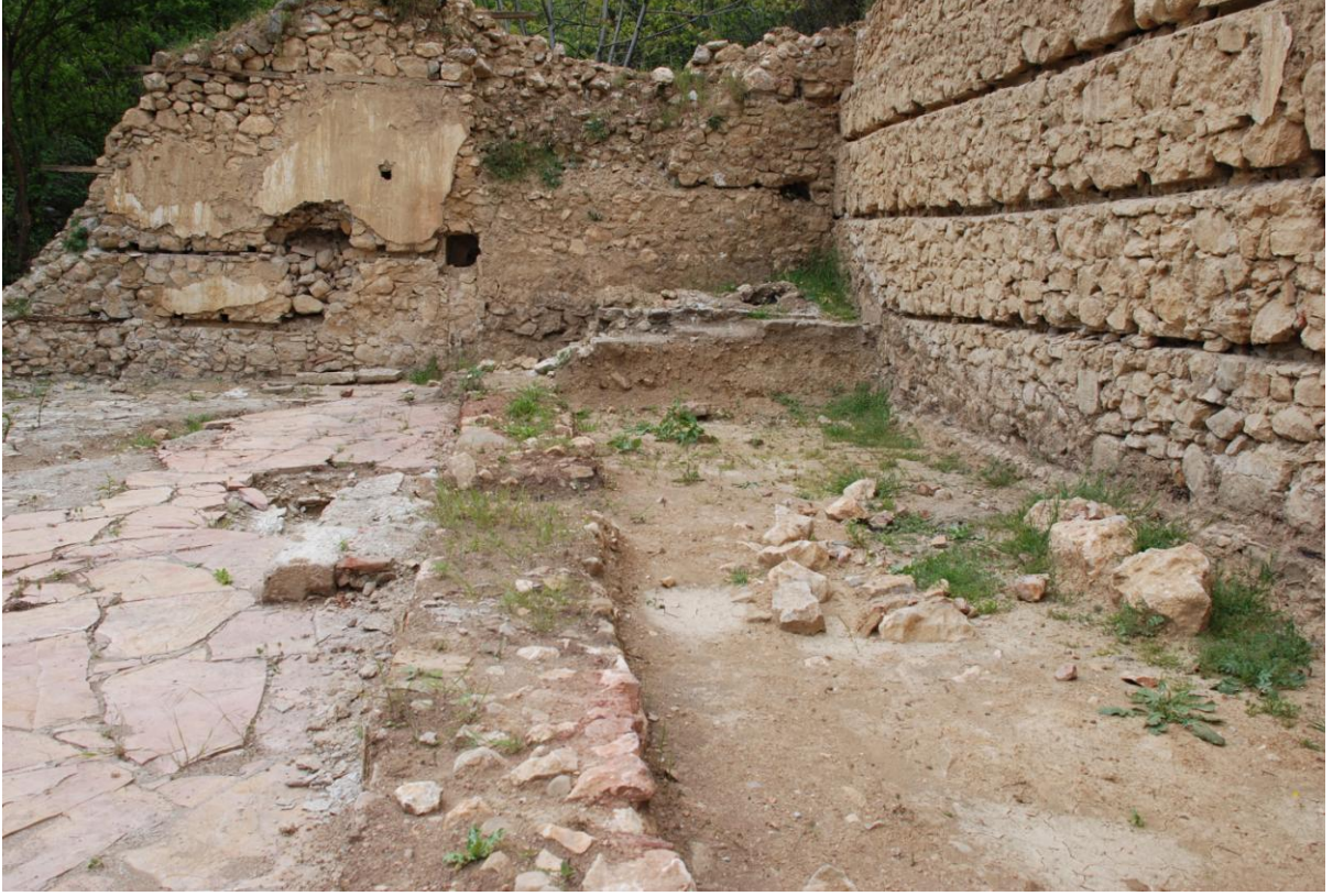
Resim 24: Osmangazi Camii'nin (avlu) 2008 yılında yapılan kazı çalışmalarında sonra iklimsel koşullardan dolayı oluşan tahribat (Bilecik).
