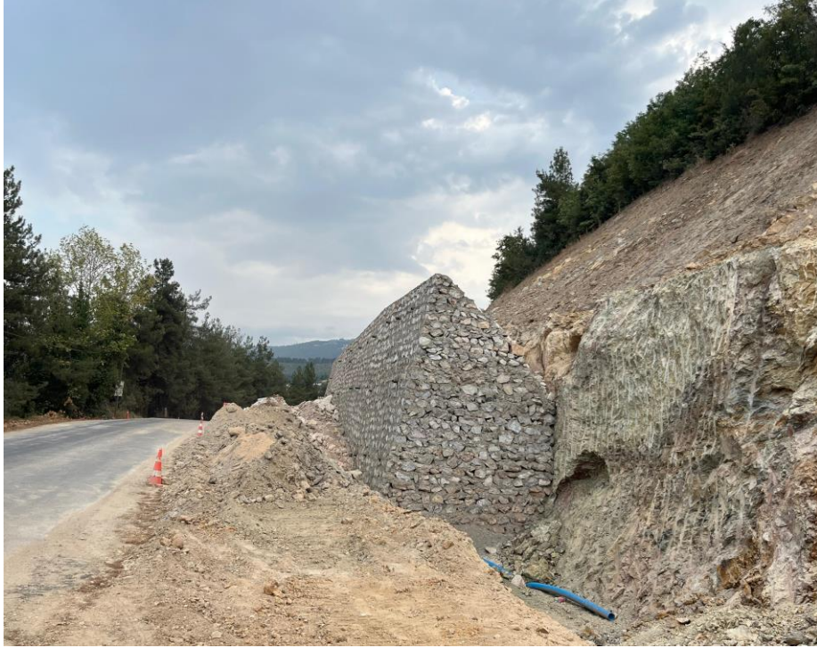
Fotoğraf 3.21. Bursa Keles yolu, toprak kaymasını engellemek amacıyla yapılan taş duvar (2024).
