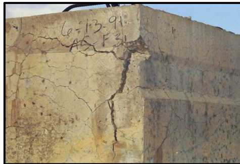
Şekil 2.8 Sülfat etkisi altında betonun parçalanması.
