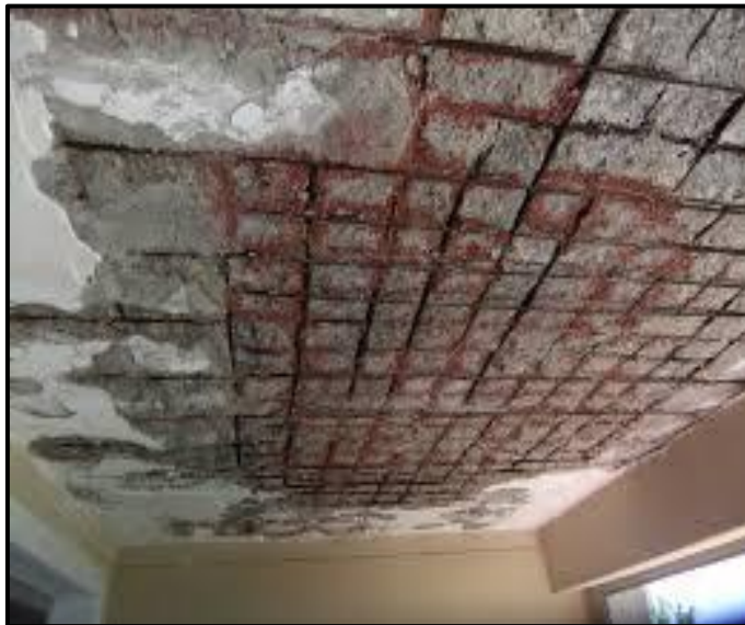
Şekil 2.11 Betonarme yapının korozyona uğraması.
