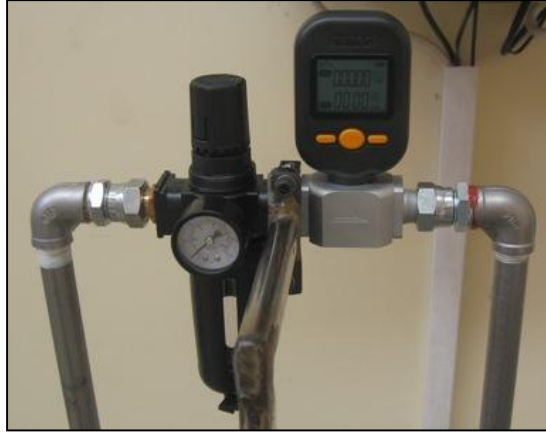
Şekil 7.14. Hava debimetresinin montaj sonrası görüntüsü.
