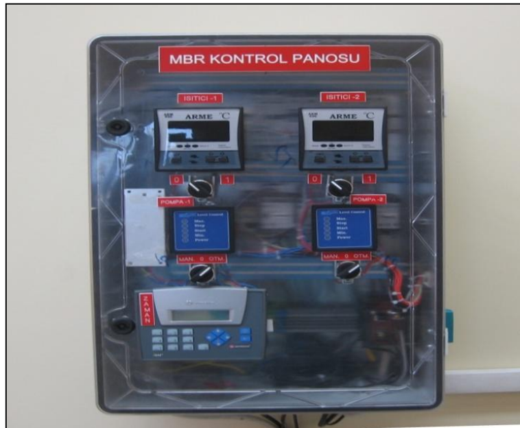
Şekil 7.32. MBR kontrol panosunun dış görüntüsü.
