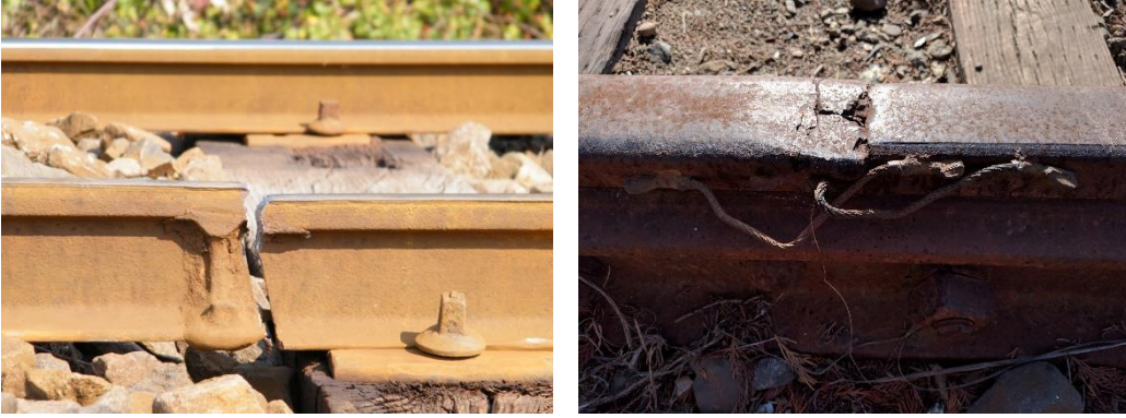
Şekil 1.2. Ray kırılması arızası
