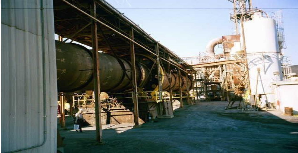
Şekil 1.13. Döner Fırın Tesisinin Görünümü
