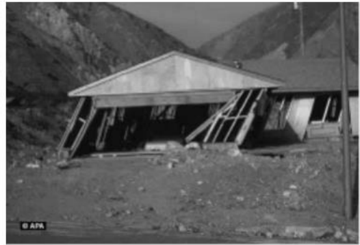
(c) Yeterli raf mukavemetinin olmaması göçmeye neden olur (fotoğraf Apa, Engineered Wood Association izniyle)
