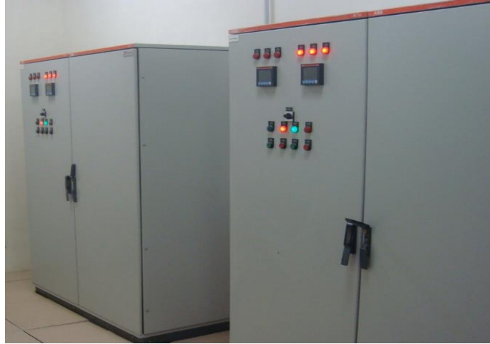
Şekil 3.17. Veri merkezi ana enerji panoları (a ve b hattı).
