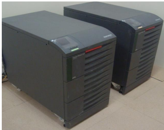
Şekil 3.15. Veri merkezi 40 kVA'lık kesintisiz güç kaynakları.
