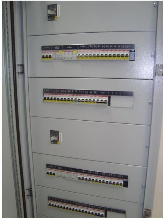
Şekil 3.20. Barındırma panosu iç görünümü.
