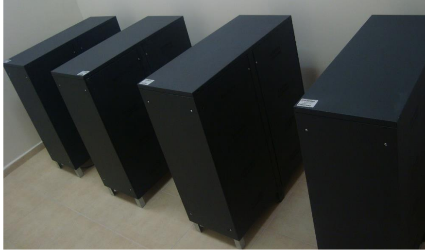
Şekil 3.16. Kesintisiz güç kaynağı aküleri.
