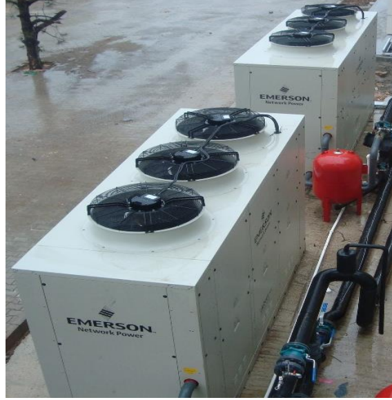
Şekil 3.21. İklimlendirme dış ünitesi (chiller).
