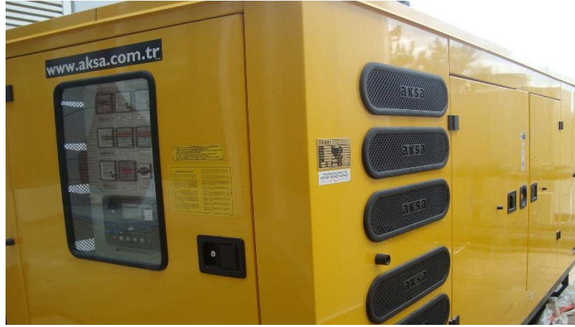
Şekil 3.14. Veri merkezi 250 kva jeneratör.
