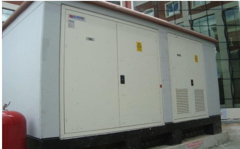
Şekil 3.11. DM 4.1 orta gerilim beton köşkü.
