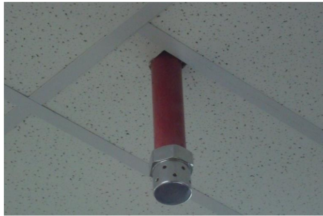
Şekil 3.36. Yangın söndürme sistemi ana bölge nozülü.
