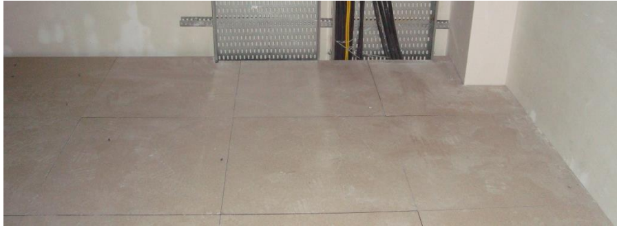
Şekil 3.5. Veri merkezi yükseltilmiş döşeme uygulaması.
